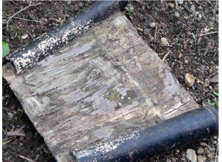
Vanne de martellière en bois
